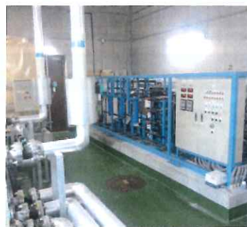
▲海水淡水化装置
