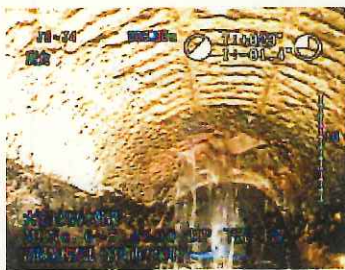
クラックからの侵入水
