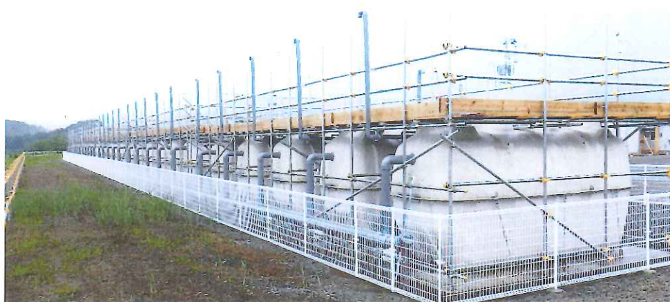
▲益城町のテクノ仮設団地に設置された浄化槽(CSL II-50型×20基、CSL II-45型×8基)
